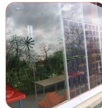
Instalación solar térmica. Tubos de vacío integrados en fachada
