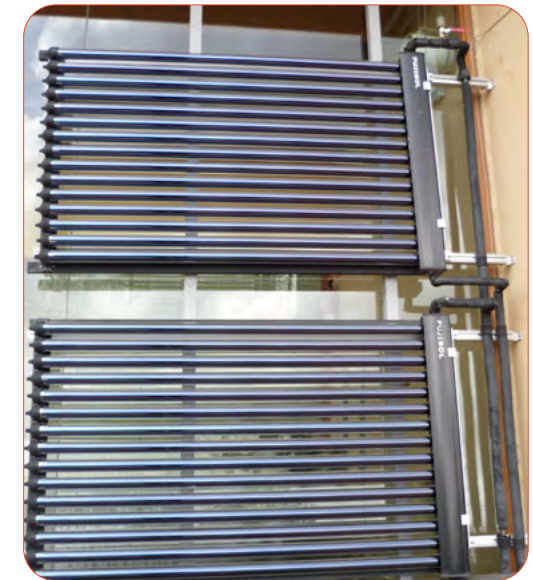
Instalación solar térmica. Tubos de vacío integrados en fachada
