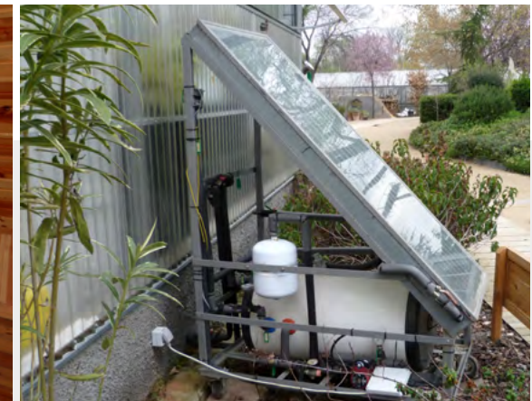
Instalación solar térmica
